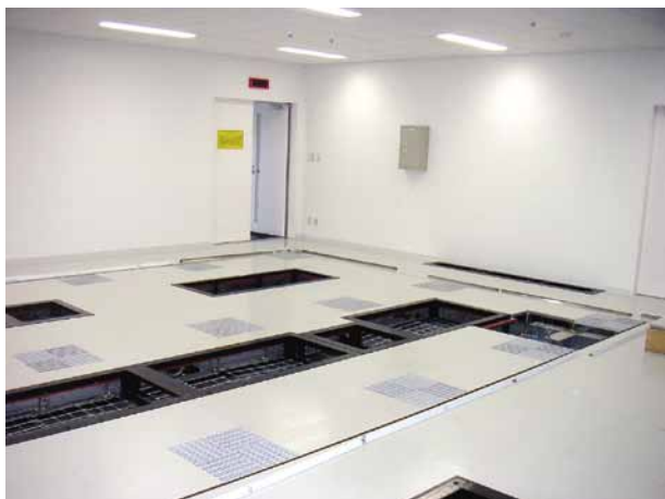
上下免震床外観
