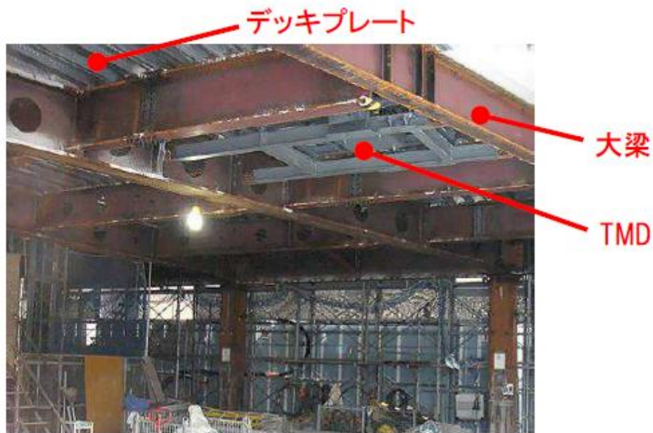
天井裏のTMD設置例(従来)
