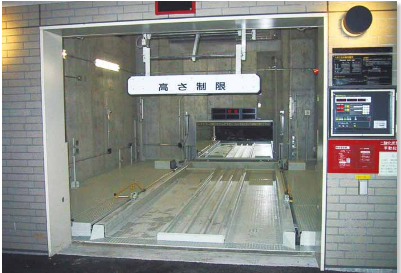
機械式駐車設備の防振
