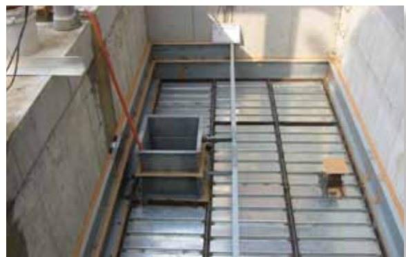
機械式駐車設備リフトビットの防振対策
