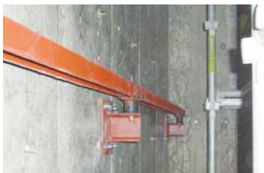
浮き壁の防振ゴム
