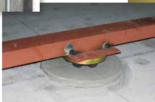
浮床の防振ゴム
