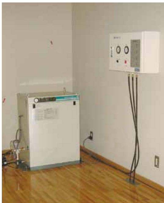
コンプレッサと操作盤
