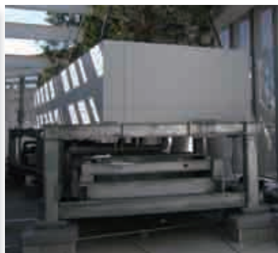
ビル屋上 TMD
