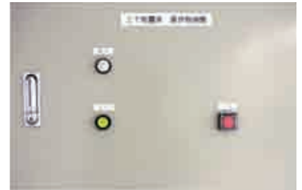
⑦操作制御盤 免震床の浮上、下降を制御する
