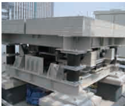
ビル屋上 TMD
