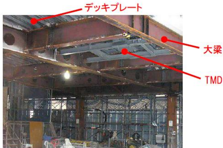
天井裏のTMD設置例(従来)
